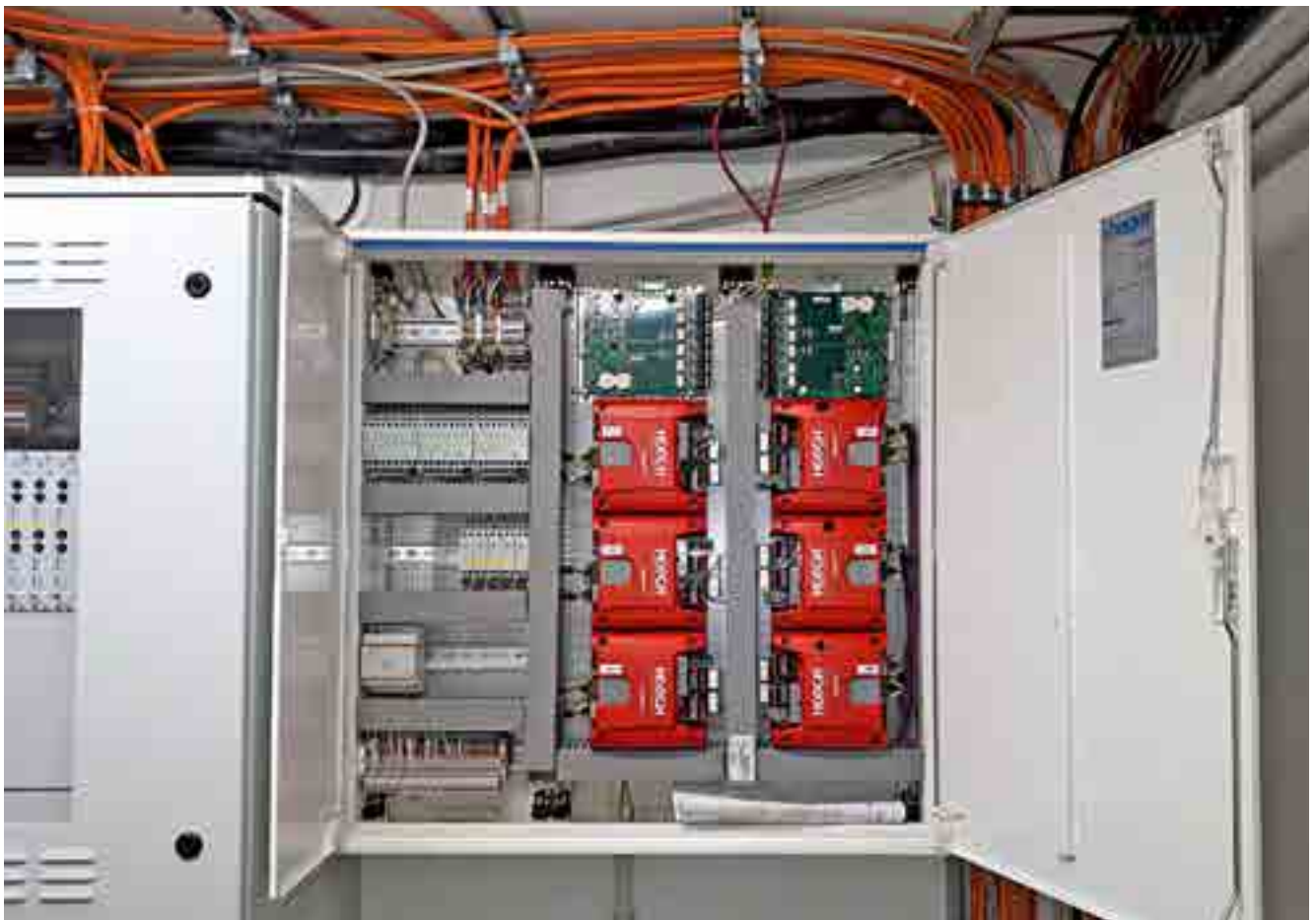
Digitalisierte Steuerung ist auch bei Entrauchern möglich.
